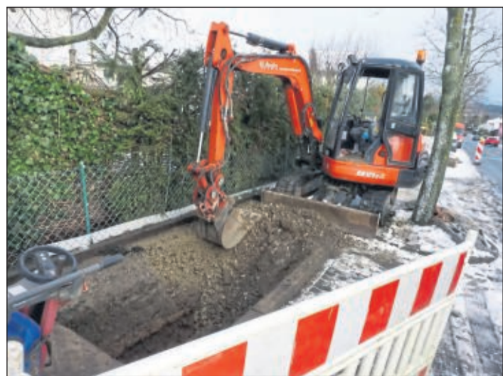
Womöglich Altersschwäche? Was die Störung in dem Erdkabel an der Hamburger Straße ausgelöst hat, ist noch unklar. Foto: Kettelhoit
