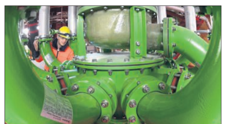
Fertiggestellt: Bei K+S kontrolliert Chemikant Andy Becker Flotationszellen in der neuen Anlage in Hattorf. Foto: Martin Schutt/dpa
